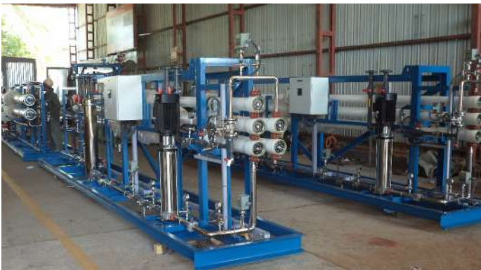
RWTP, WWTP, UF – RO Skid (GE WATER)
